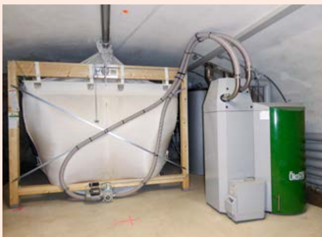
Der neu eingerichtete Heizraum mit Pelletskessel und Gewebetank.
