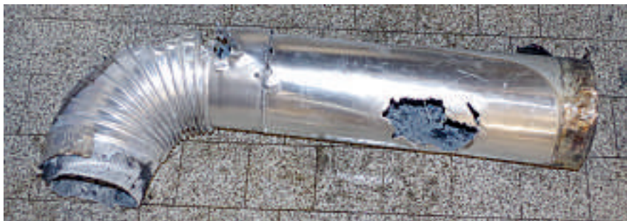
Questo impianto di scarico dell'aria ha vissuto giorni migliori.
