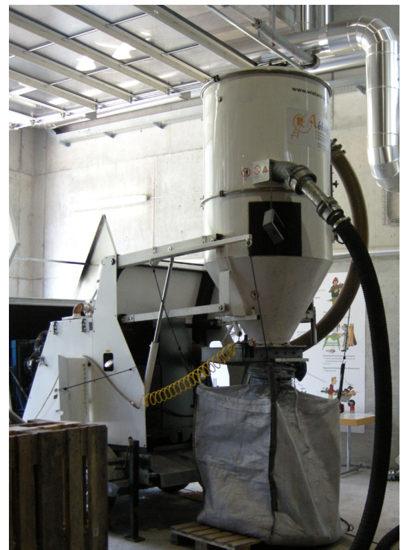
Aspirateur pour grandes installations. Photo : Patrick Abbühl
